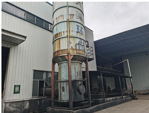
锅炉湿式静电除尘器
