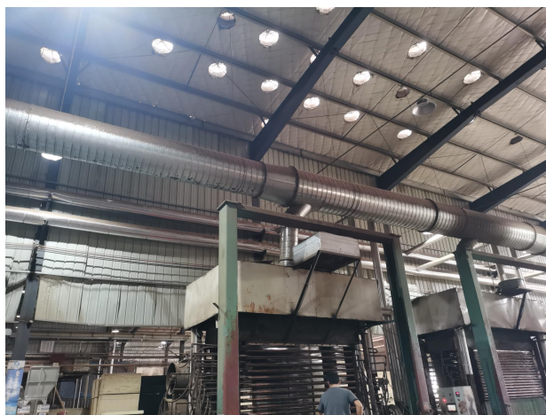
热压废气收集管道
