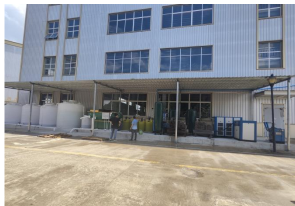
项目污水处理设施
