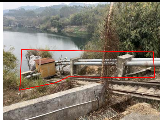
抽水泵房及输水管道
